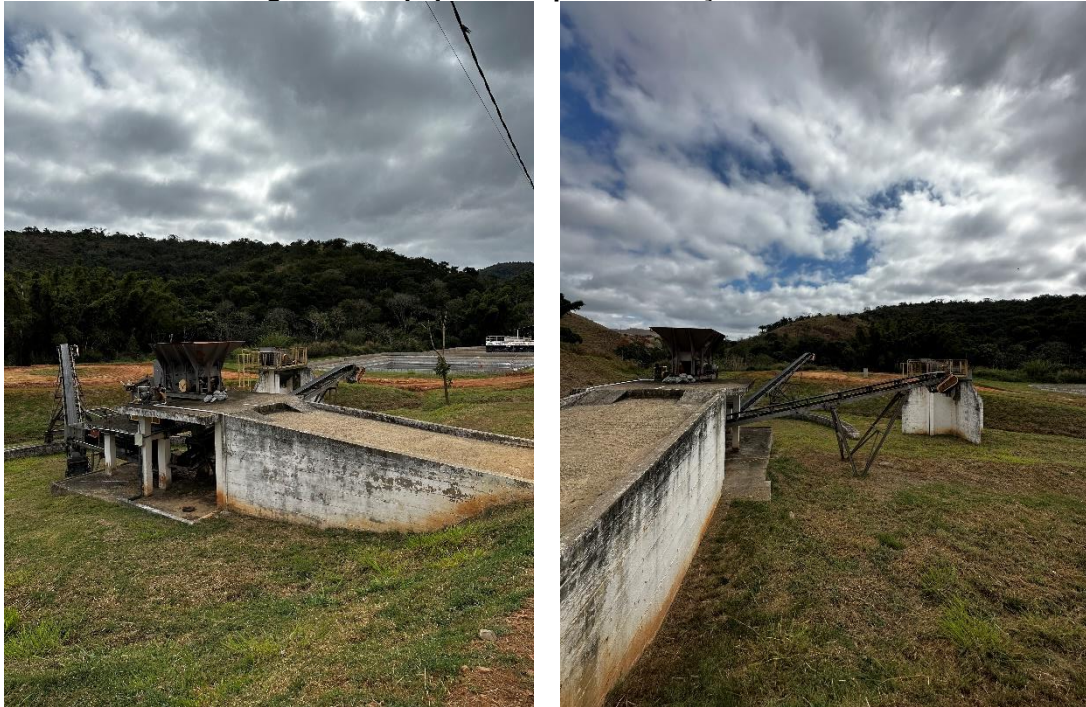
Figura 59: Equipamento para Trituração de RCC
