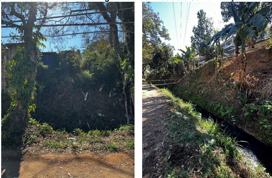
Figura 105: Áreas de Risco - Escorregamento de Encosta e Contaminação de Curso d'Água
