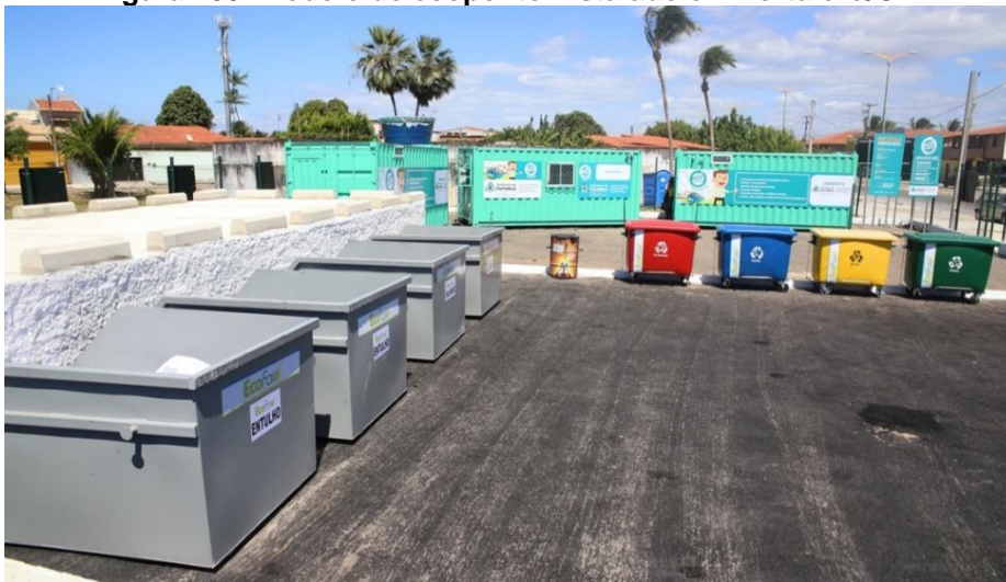
Figura 130: Modelo de ecoponto instalado em Fortaleza/CE.
