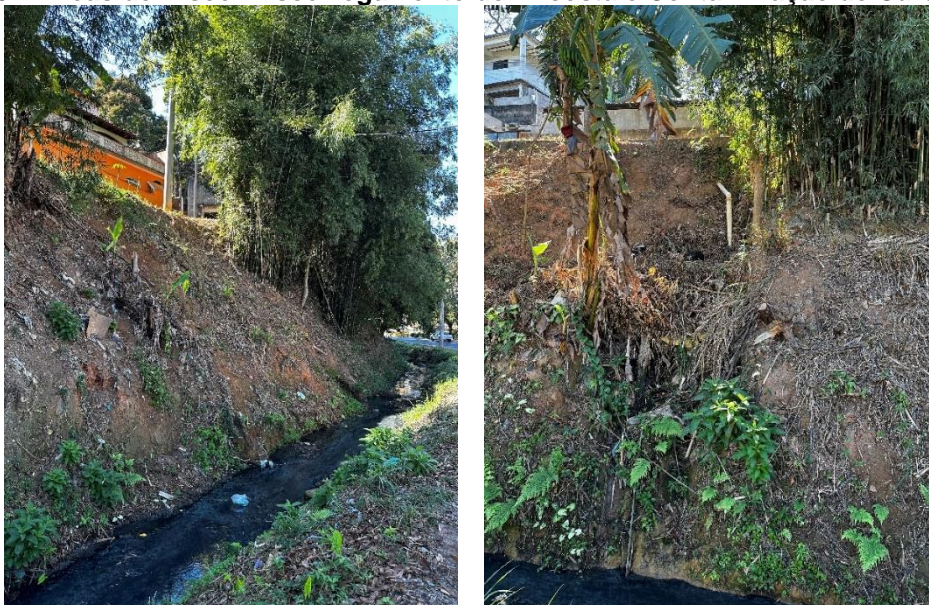
Figura 104: Áreas de Risco - Escorregamento de Encosta e Contaminação de Curso d'Água
