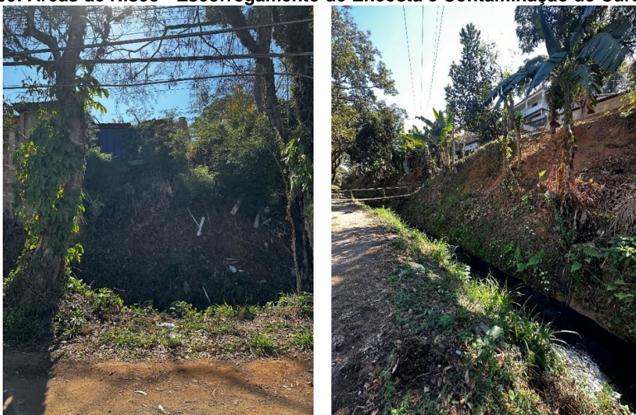
Figura 105: Áreas de Risco - Escorregamento de Encosta e Contaminação de Curso d'Água
