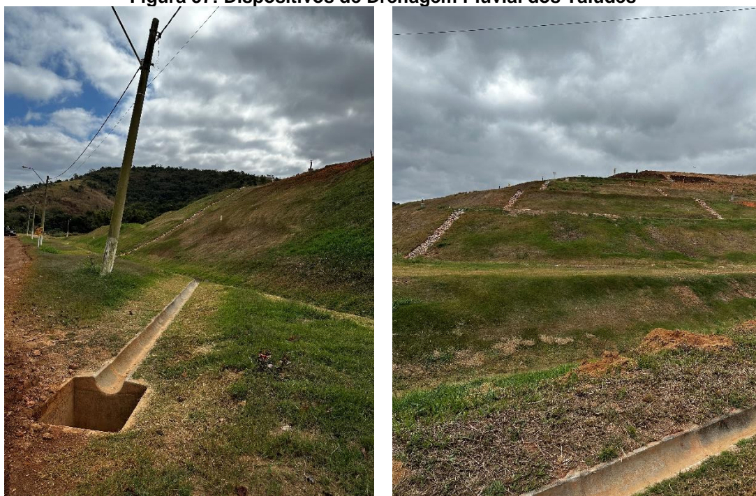
Figura 57: Dispositivos de Drenagem Pluvial dos Taludes
